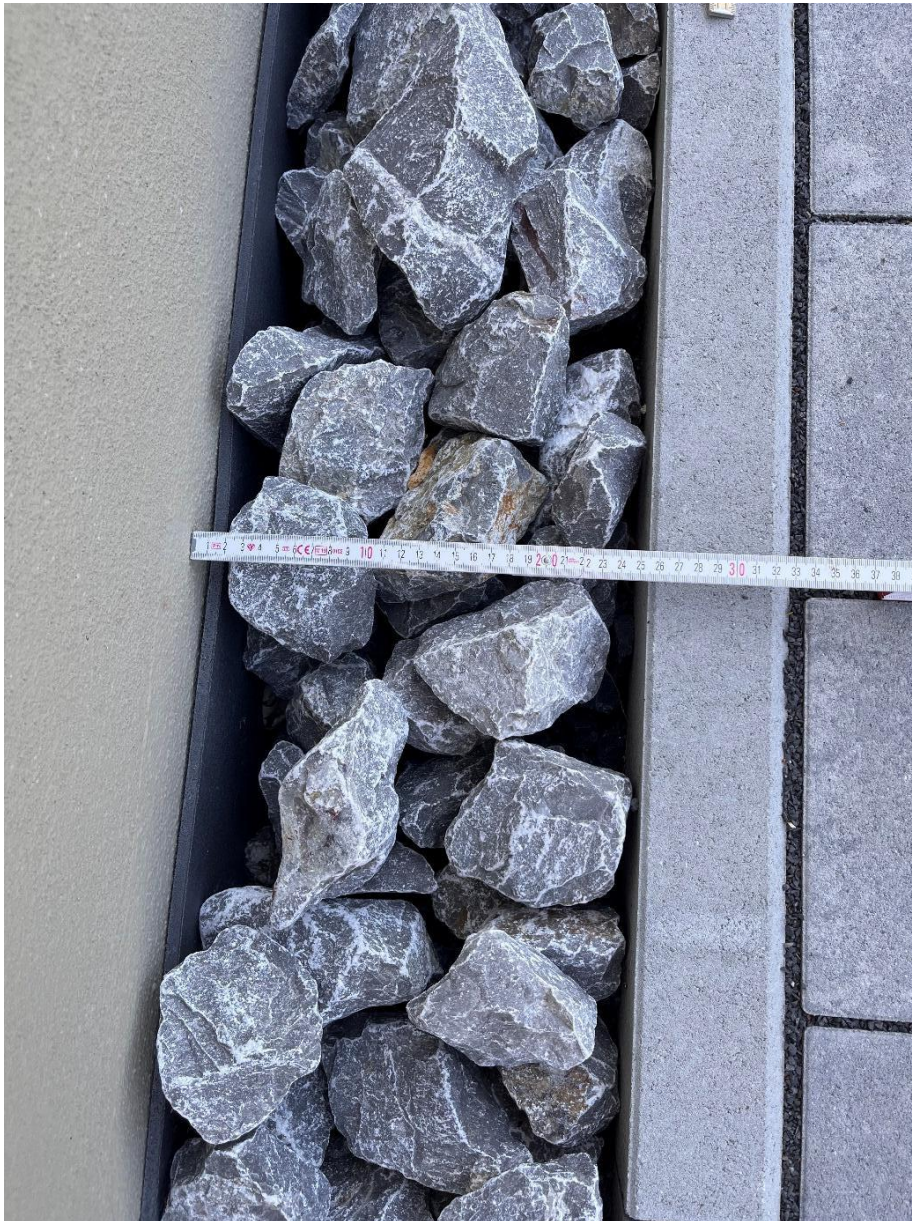
Bild 02: Spritzschutzstreifen aus grobschlägigen Steinen. Breite bis Sockel ca. 25 cm
