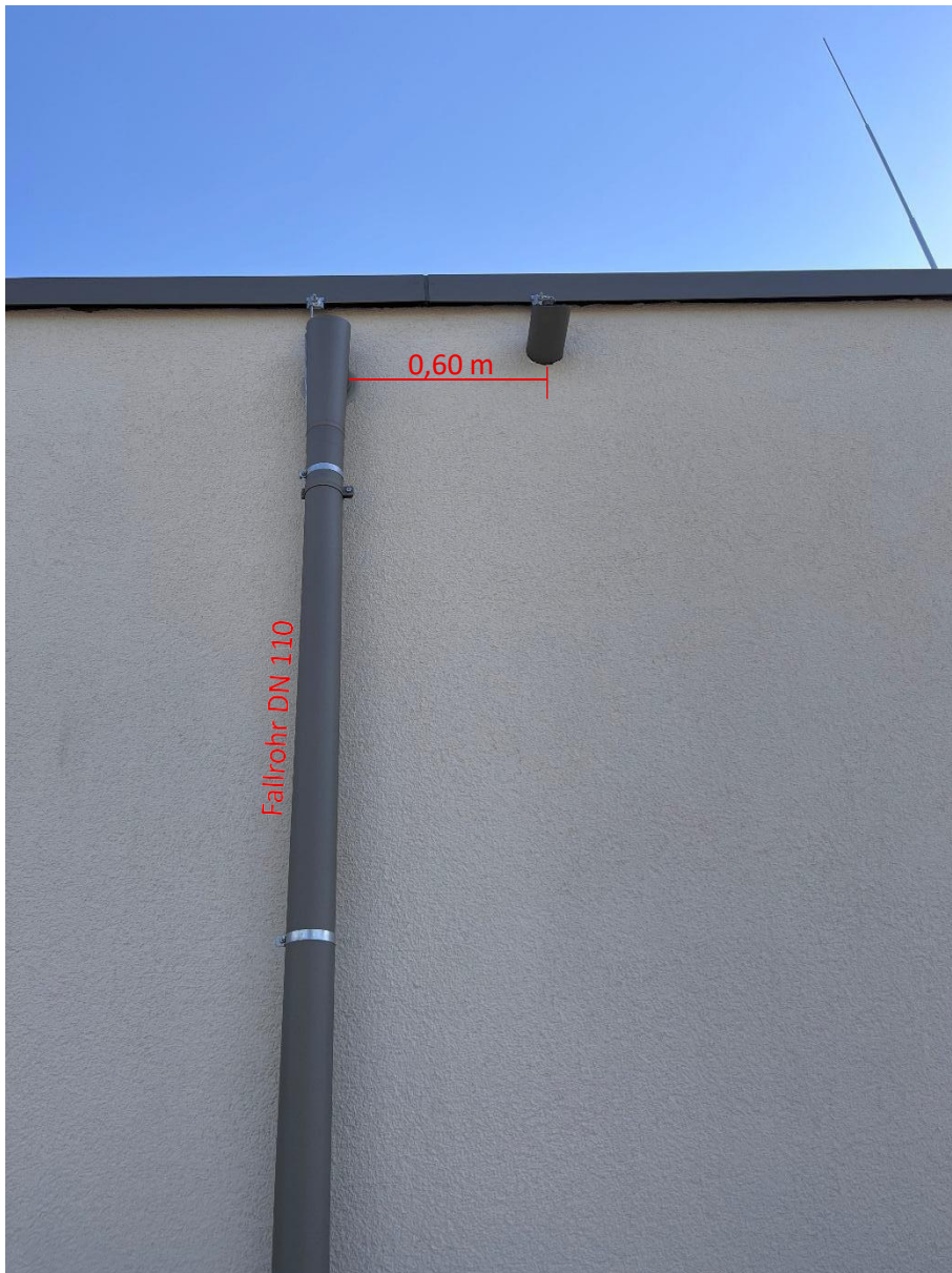
Bild 05: An der Arbeitsfläche angrenzendes Fallrohr als DN 110, Speier Notüberlauf mit einem Abstand von ca. 60 cm zum Fallrohr und ca. 20 cm zum Attikablech.
