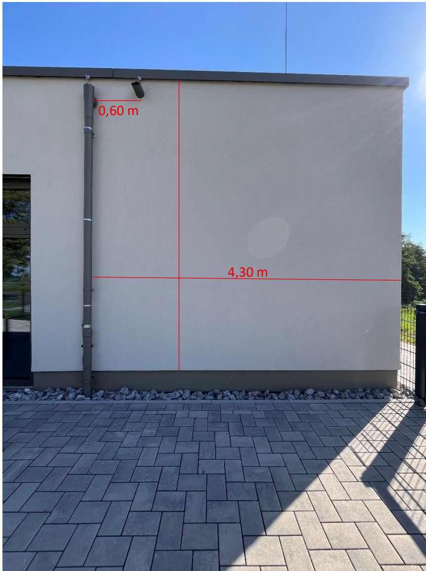
Bild 01: Wandfläche ca. 4,00 m Höhe und 4,30 m Breite.
